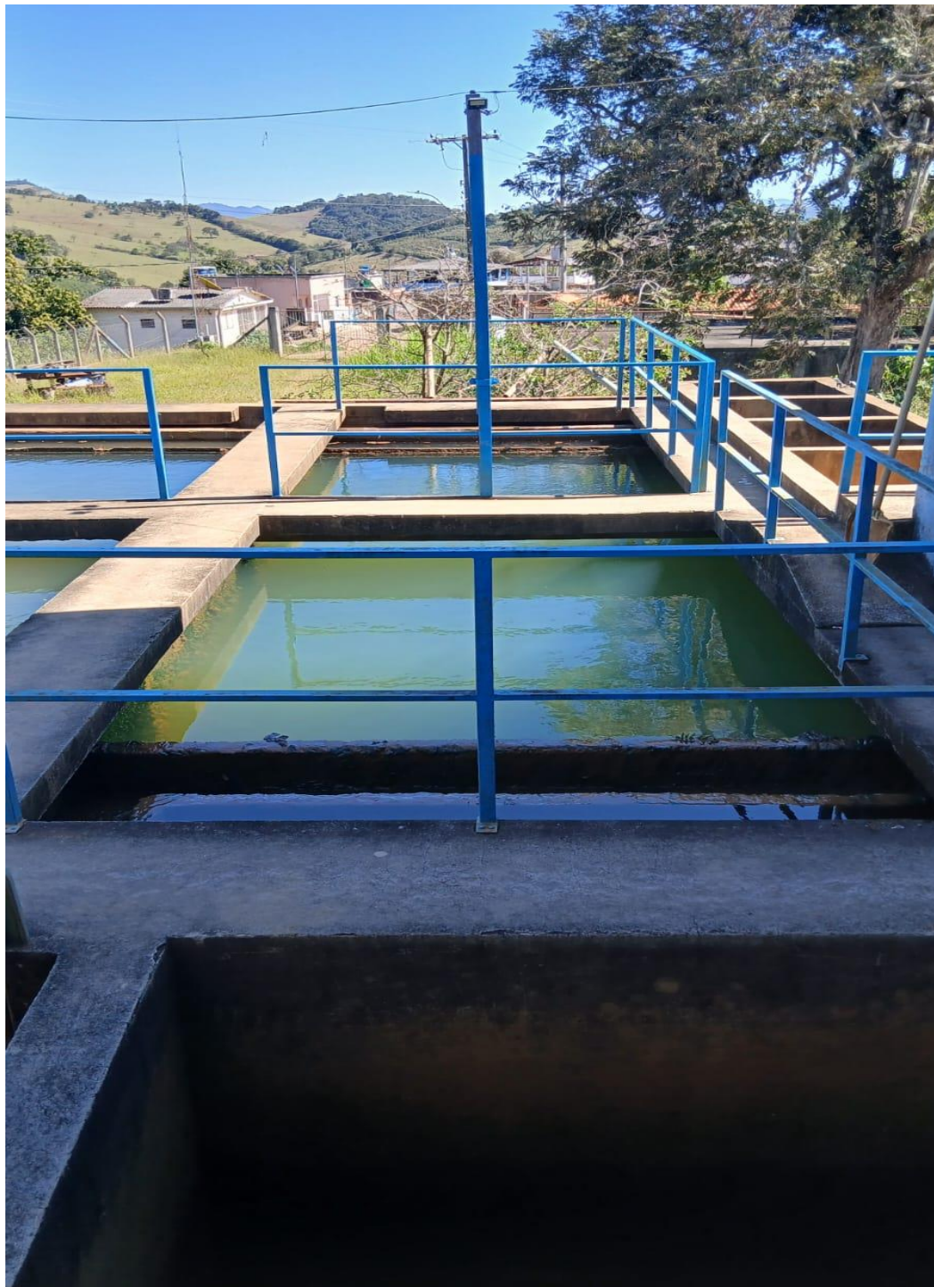
Decantador da ETA Soledade de Minas.
